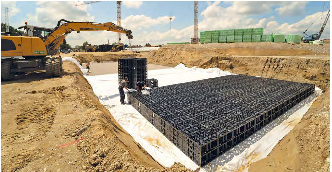
Die GRAF EcoBloc Inspect Module wurden innerhalb von nur zweieinhalb Arbeitstagen vor Ort zu einem mehrlagigen Blockverbund montiert
