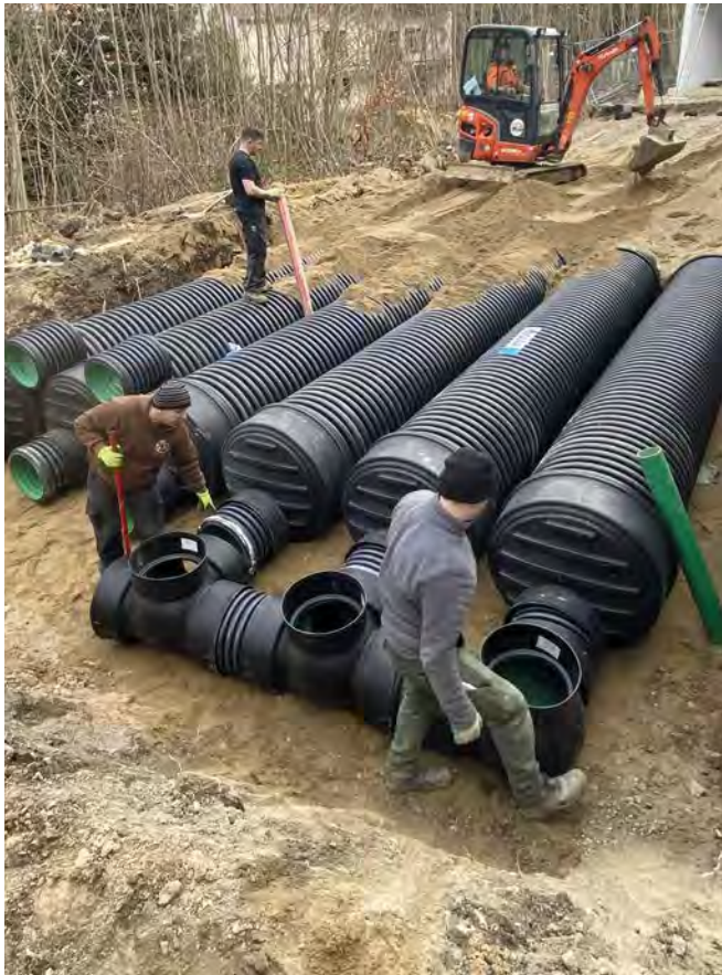
Stauraumkanal DN 800 mit MULTI-inspect-Verteilerschächten
